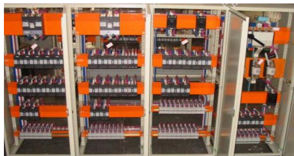
Figura 9 - Exemplo de um painel elétrico
