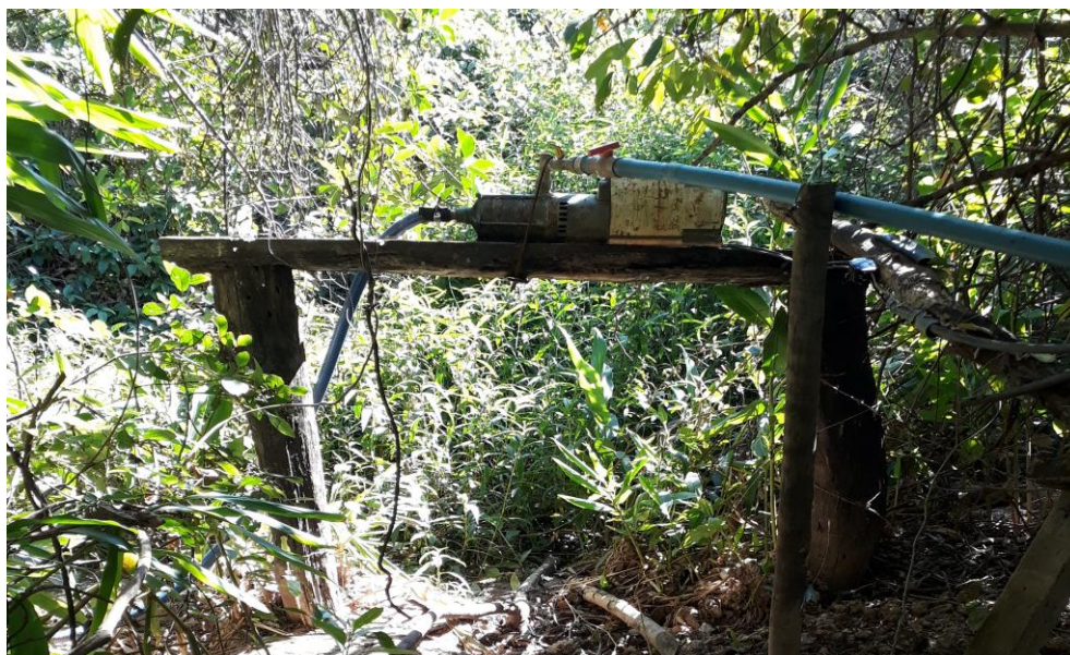
Figura 07 - Captação de água na nascente do Riacho Canabrava
