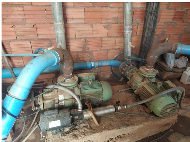
Figura 8 – Sistema de bombeamento da área em estudo
