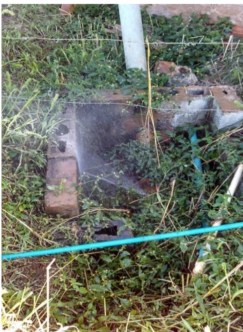
Figura 06 – Vazamento da tubulação após o sistema de bombeamento.
