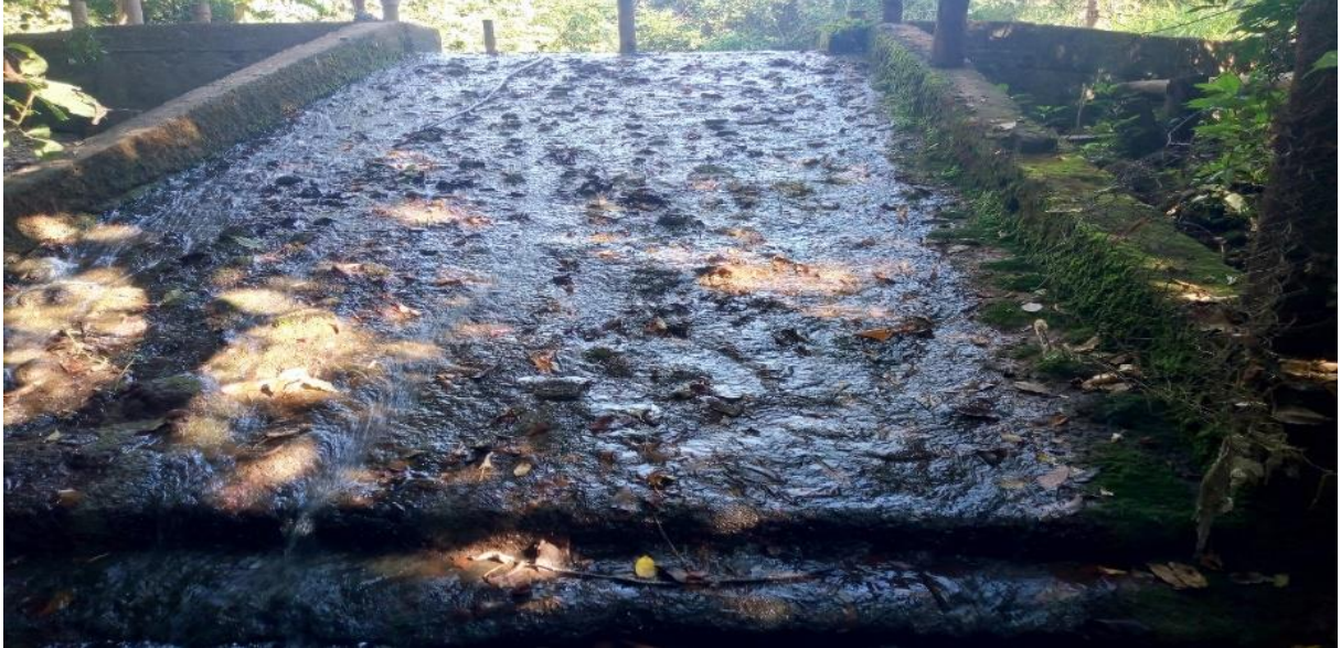
Figura 09 – Estrutura do barramento irregular no trecho A da microbacia do rio do Cedro
