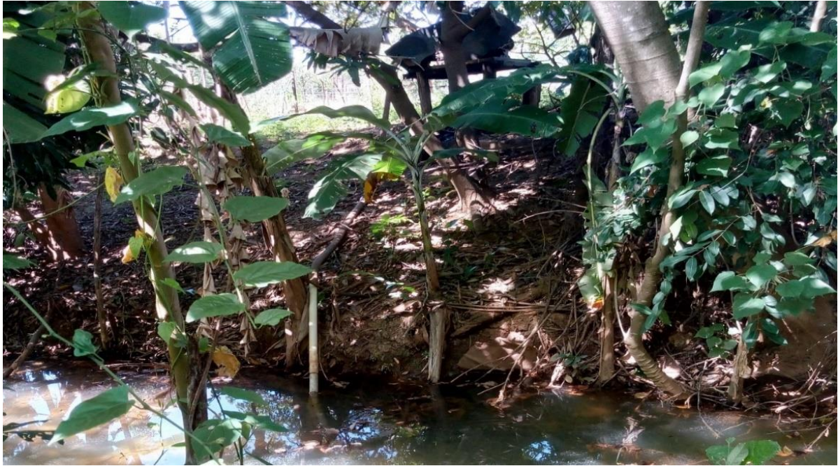
Figura 17 – Bomba de captação de água instalada próxima a margem
