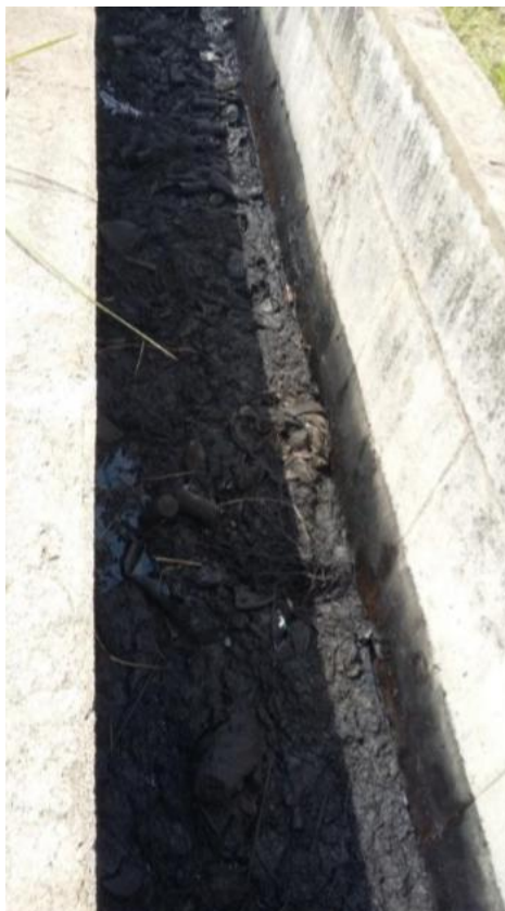
Figura 10 - Calha condutora do tratamento preliminar da ETAR de Infulene, Maputo, Moçambique
