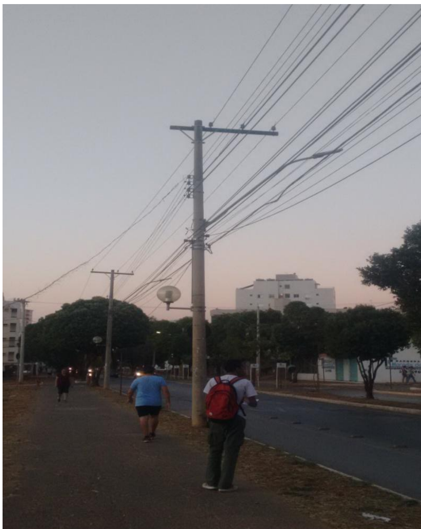
Figura 14- Padrão convencional de fiação para iluminação utilizado em todo trecho da avenida analisada.
